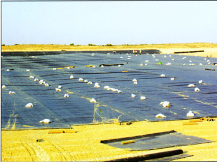
Décharge contrôlée de Medenine (Tunisie)
